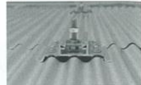
取り付け金具の詳細。金物はアルミの型材。鋼板波板の山部分にビスで固定するのがポイント
