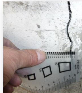
今回の不具合箇所は、この写真のように大きなクラックからの漏水でした。
